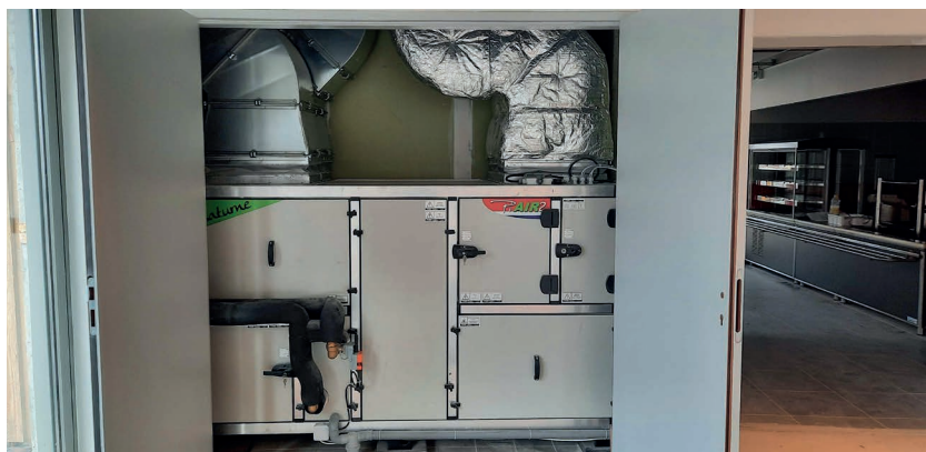
CTA Double Flux Rdc - Débit : Souf. 3200 m 3 /h / Rep. 3200 m 3 /h.
