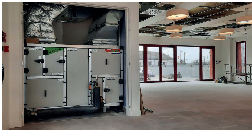
CTA Double Flux Etage - Débit : Souf. 2500 m 3 /h / Rep. 2500 m 3 /h.
